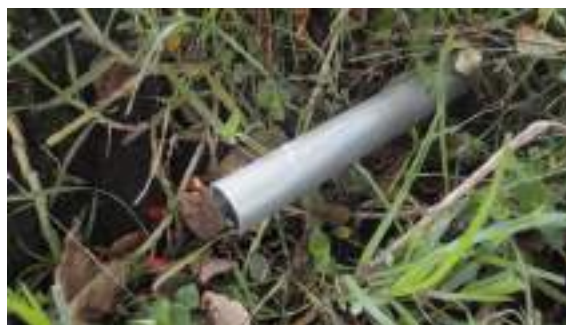
Tubería de la red de distribución
