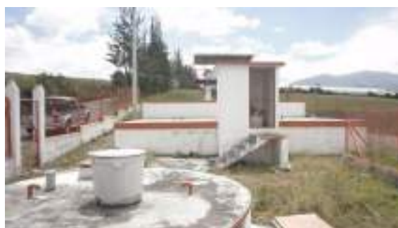
Tanques circulares de 40 y 25 m 3
