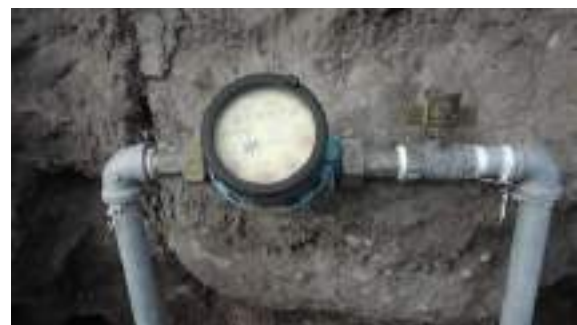
Medidor de agua potable
